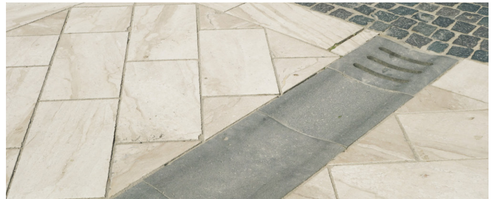
Abb. 109: Offene Entwässerung in hochwertigem Belag
